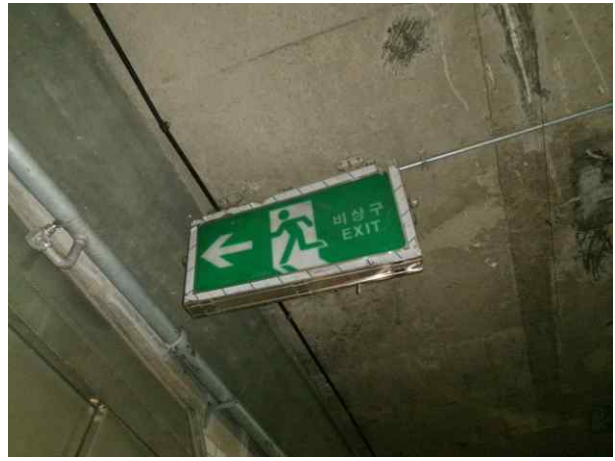
RAMP-D S57 비상구 표지판 파손
