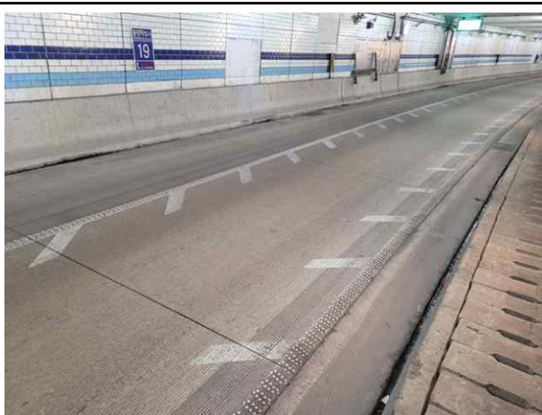
RAMP-D 포장부 S26~28 들뜸(S28)
