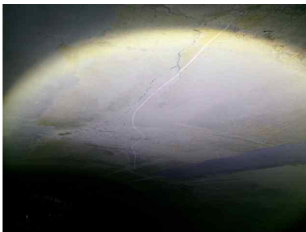
RAMP-D NATM구간 천단부 S51 균열(Cw=0.5mm)
