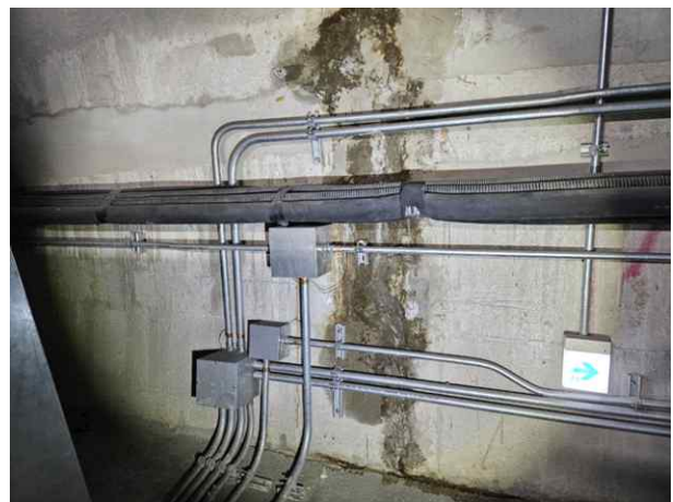
RAMP-D 전기실 측벽부 누수 및 백태
