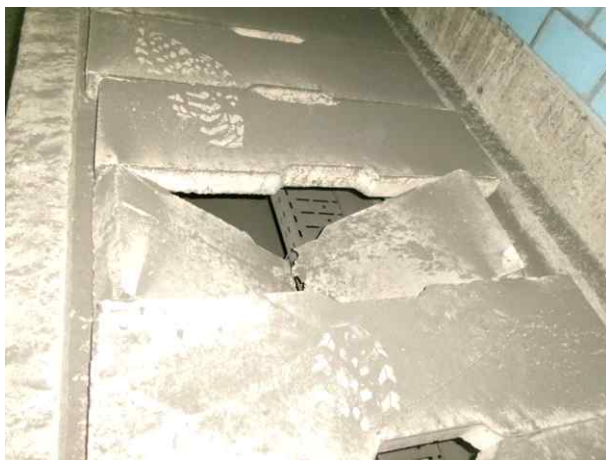
본선 공동구 S543 덮개파손
