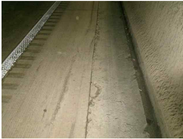
본선 포장부 S467 파손
