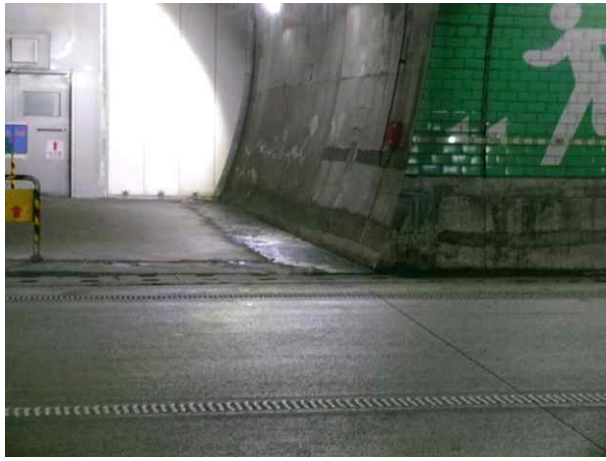
피난연락갱 S160 누수(떨어짐)
