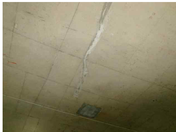
본선 BOX구간 슬래브 S003 균열부백태
