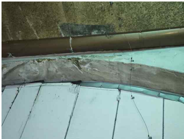
RAMP-D NATM구간 천단부 S54 파손
