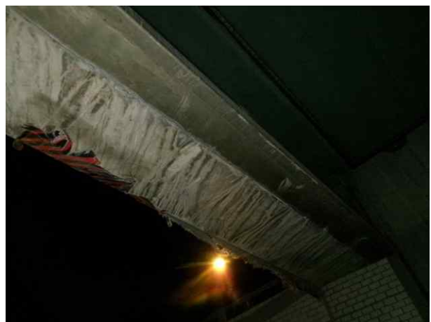
RAMP-D BOX구간 슬래브 S60 백태
