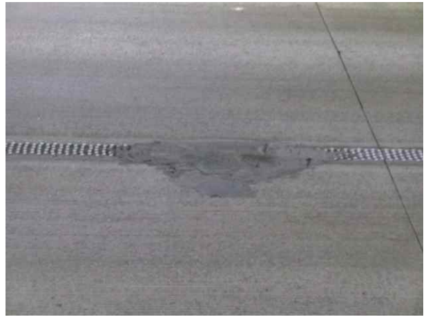
본선 포장부 S623 파손
