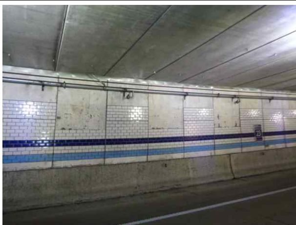
RAMP-D NATM구간 측벽부 S17 타일탈락
