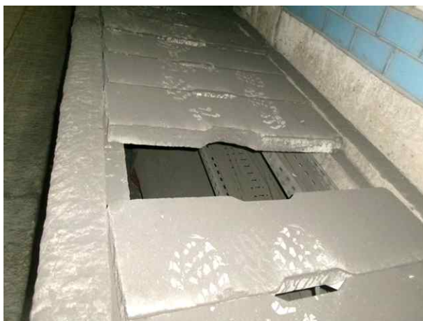
본선 공동구 S685 덮개탈락
