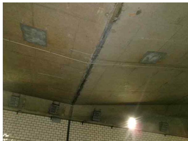
본선 BOX구간 슬래브 S003 누수(스며있음)
