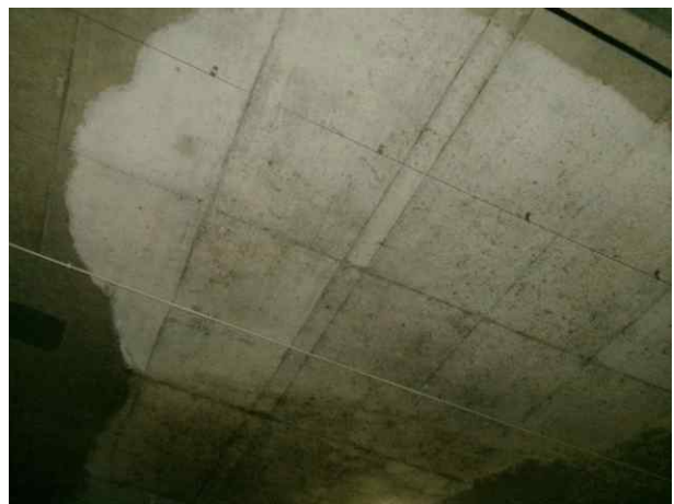
RAMP-D BOX구간 슬래브 S58 망상균열( C_w=0.1\sim0.2\text{mm} )
