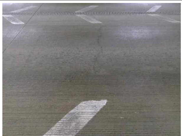
본선 포장부 S661 균열
