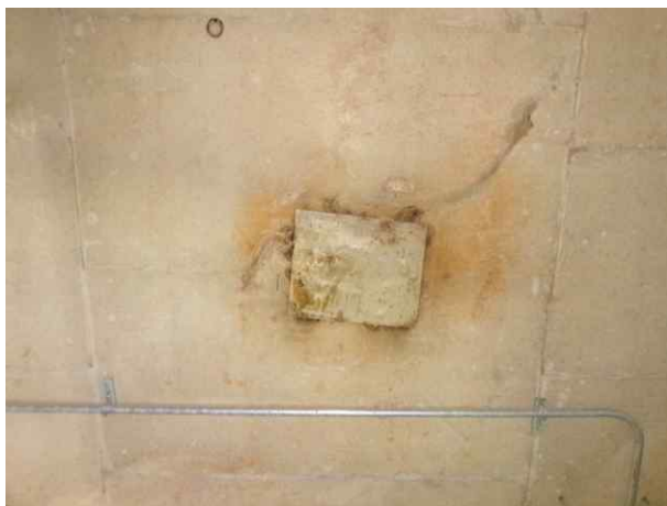
소화수조 S006 슬래브 누수흔적
