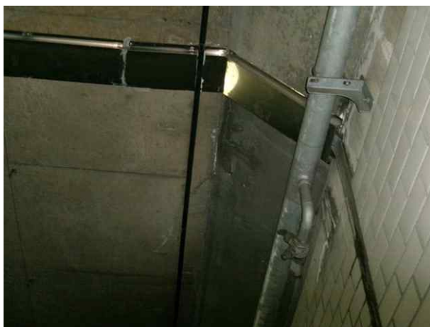
RAMP-D BOX구간 슬래브 S59 누수(스며있음)
