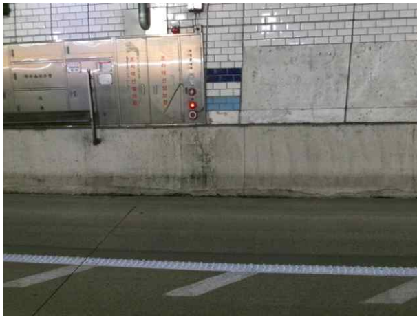
RAMP-D 공동구 S35 파손
