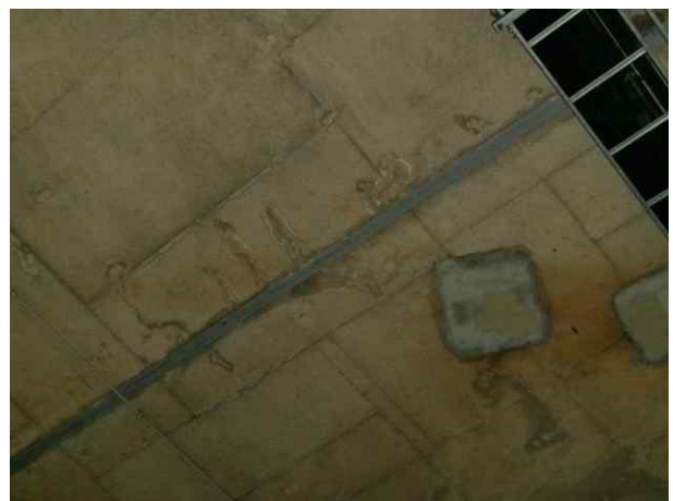
본선 BOX구간 슬래브 S005 누수흔적
