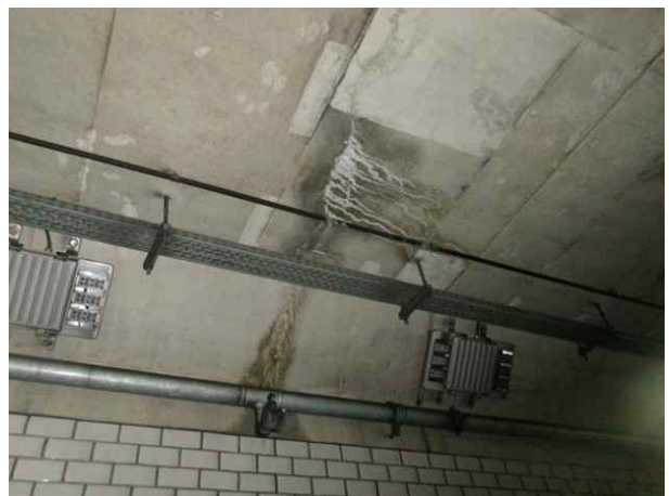
본선 BOX구간 슬래브 S714 누수(스며있음)
