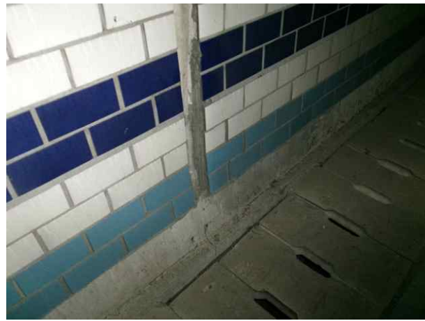
RAMP-D NATM구간 측벽부 S49 파손
