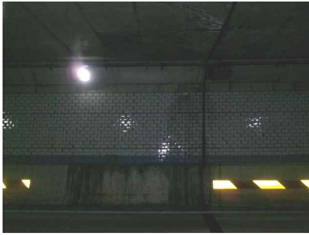
본선 BOX구간 벽체 S712 누수흔적
