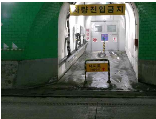
피난연락갱 S057 누수(떨어짐)
