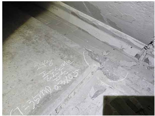
RAMP-D 풍도슬래브 S53 상면 파손
