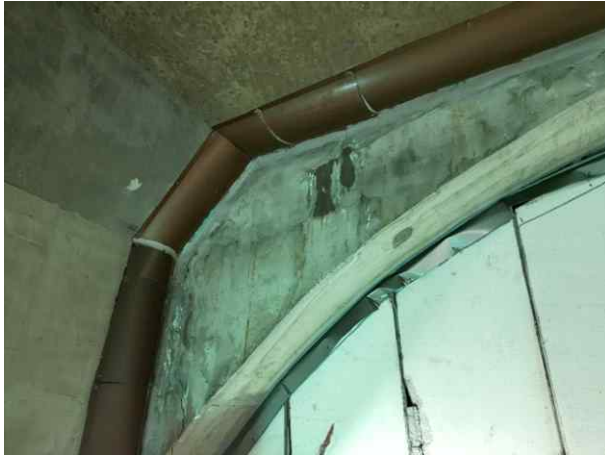
RAMP-D 배수시설 S55 유도배수관 누수
