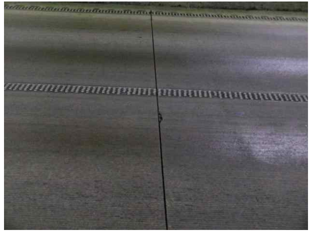
본선 포장부 S673 파손
