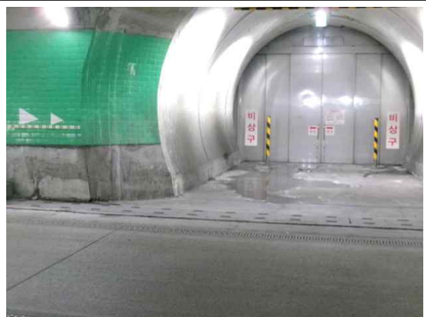
피난연락갱 S144 누수(떨어짐)
