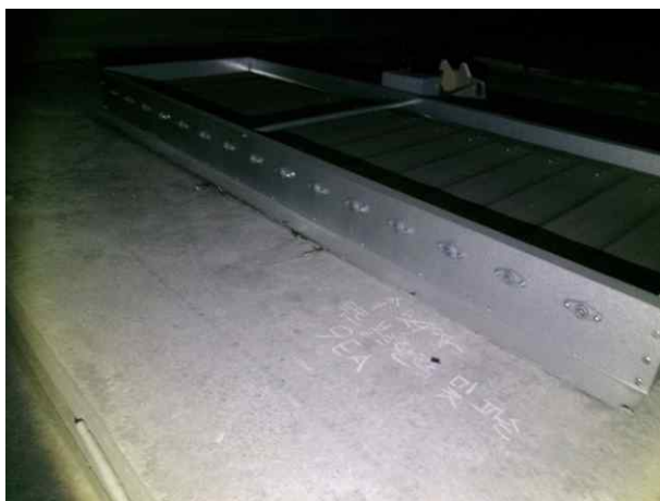
RAMP-D 풍도슬래브 S53 댐퍼 볼트탈락 및 파손
