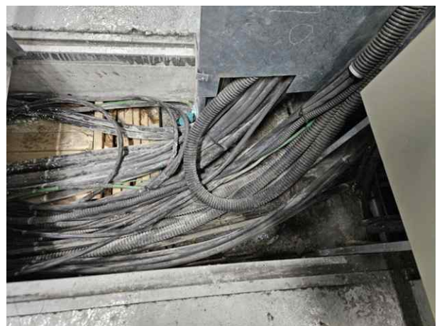
RAMP-D 전기실 트레이 내부 채수
