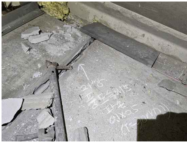
RAMP-D 풍도슬래브 S53 상면 파손
