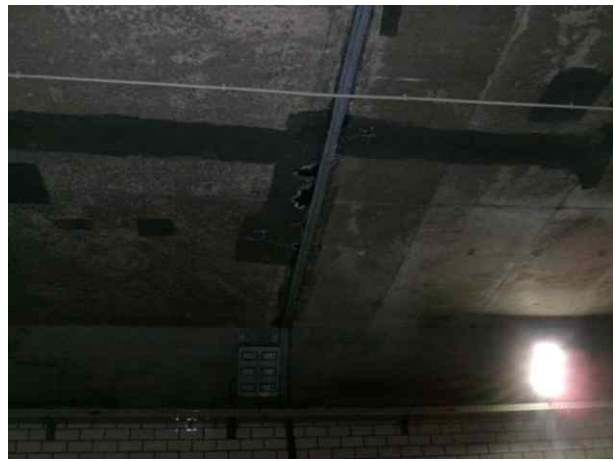
RAMP-D BOX구간 슬래브 S58 누수(스며있음)
