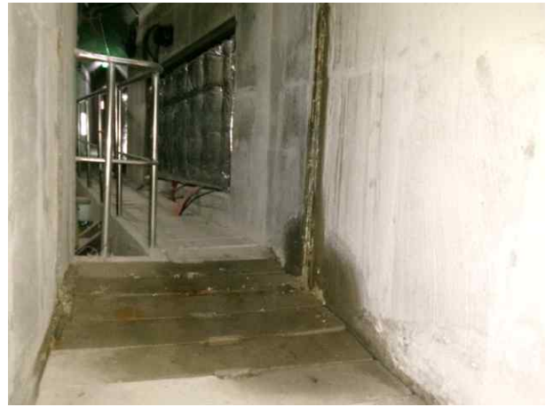
RAMP-D BOX구간 벽체 S57 누수(떨어짐)
