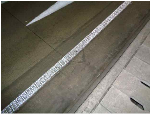
RAMP-D 포장부 S03 파손
