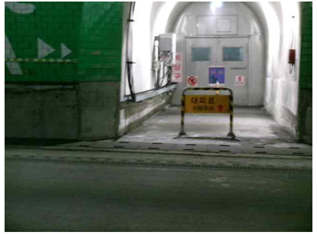
피난연락갱 S566 누수(떨어짐)
