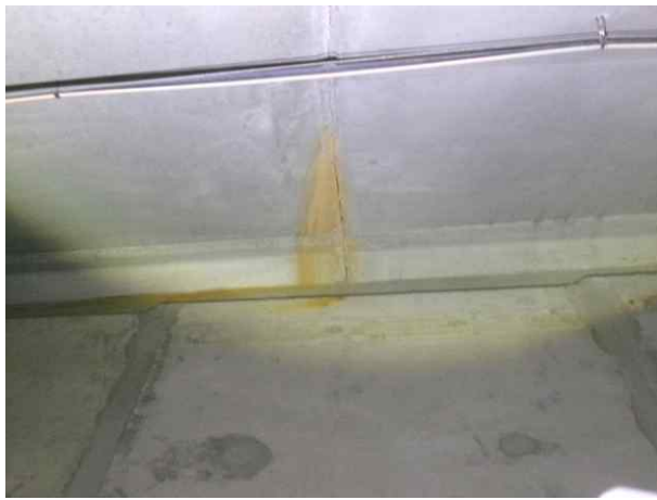
RAMP-D NATM구간 천단부 S25 누수흔적
