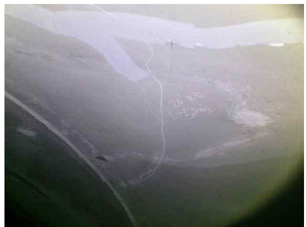
RAMP-D NATM구간 천단부 S22 균열(Cw=0.3mm)
