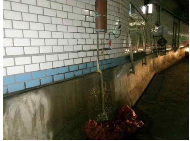
RAMP-D 배수시설 S57 유도배수관 길이부족
