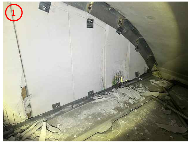
RAMP-D 풍도슬래브 S54 격벽 파손 및 철근노출(내측)
