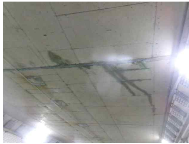
본선 BOX구간 슬래브 S001 누수(떨어짐)
