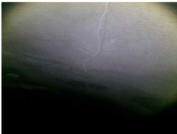
RAMP-D NATM구간 천단부 S10 균열(Cw=0.5mm)
