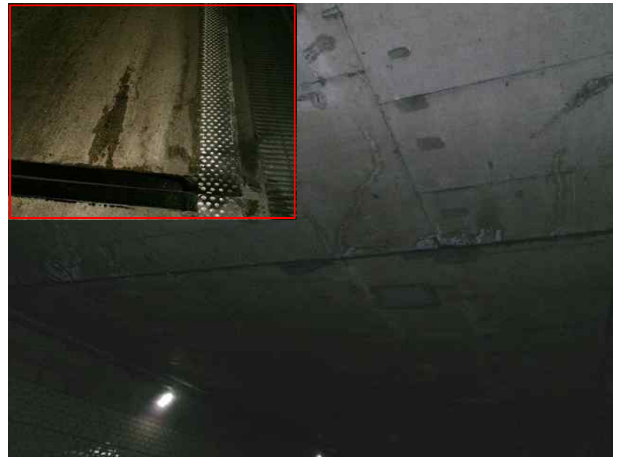
본선 BOX구간 슬래브 S712 누수(떨어짐)
