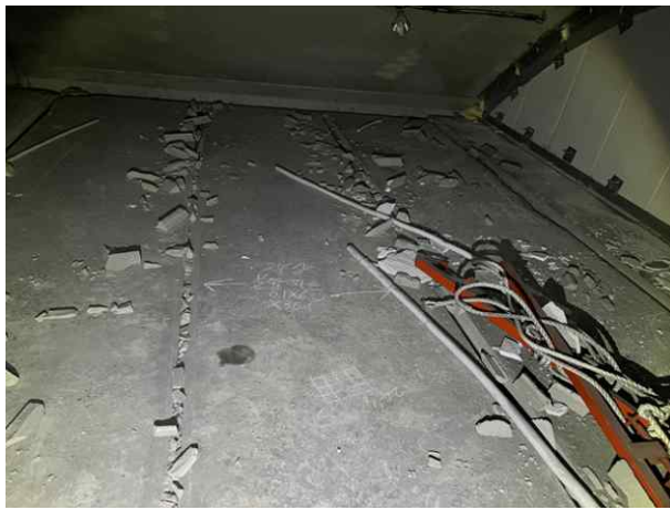
RAMP-D 풍도슬래브 S54 상면 몰탈파손
