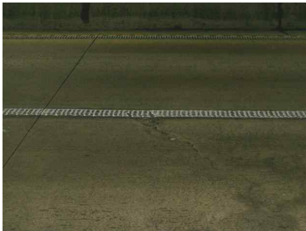
본선 포장부 S637 파손, 망상균열
