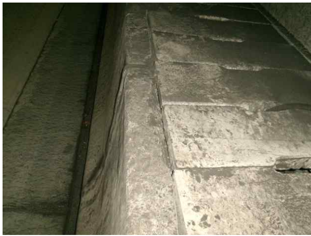
본선 공동구 S391 파손
