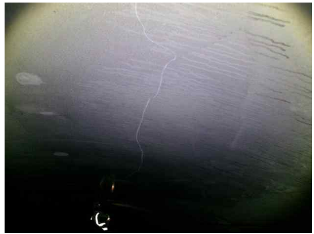
RAMP-D NATM구간 천단부 S07 균열(Cw=0.5mm)
