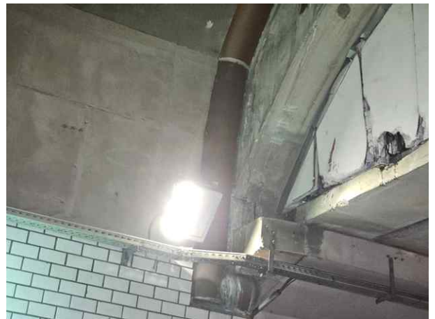
RAMP-D NATM구간 천단부 S54 파손
