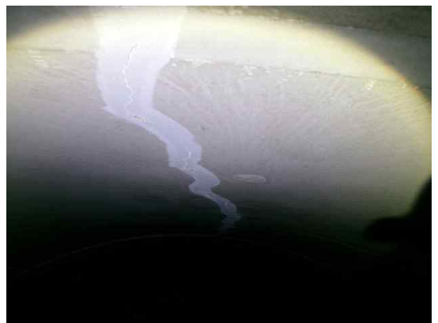
RAMP-D NATM구간 천단부 균열보수 양호
