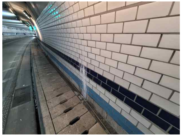
RAMP-D NATM구간 측벽부 S29 백태
