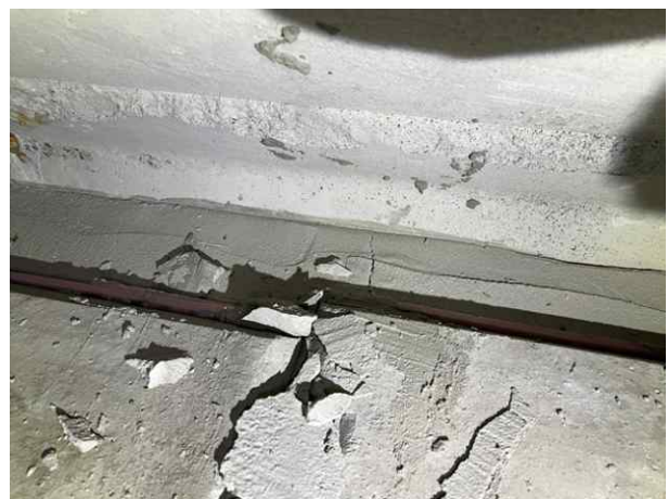
RAMP-D 풍도슬래브 S53 상면 몰탈파손
