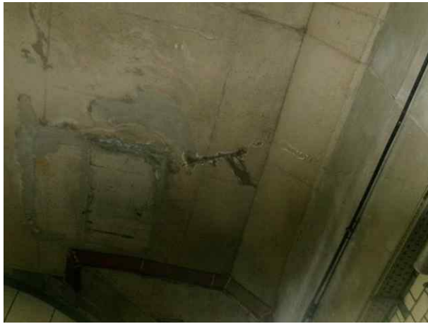
본선 BOX구간 슬래브 S006 균열부백태
