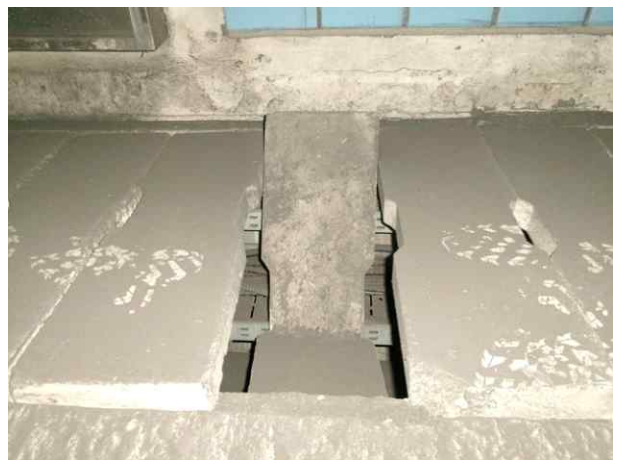
본선 공동구 S681 덮개파손
