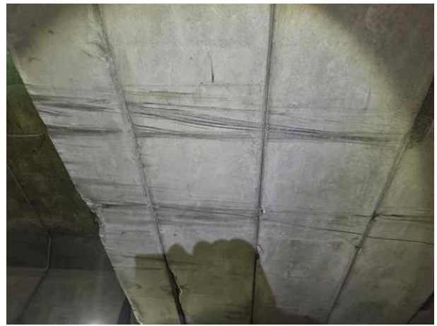
RAMP-D 풍도슬래브 S54 하면 파손(굽힘)
