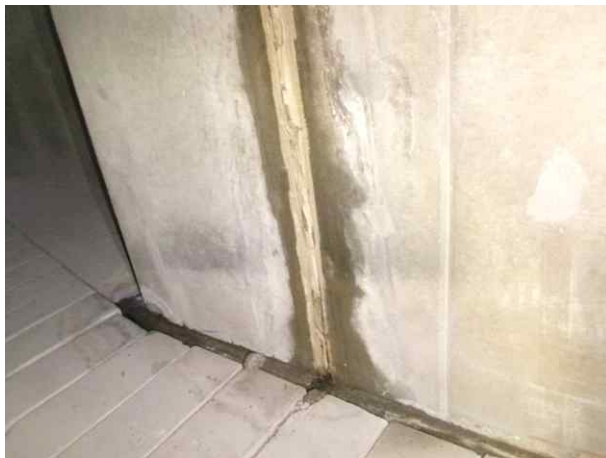
RAMP-D BOX구간 벽체 S58 누수(스며있음)
