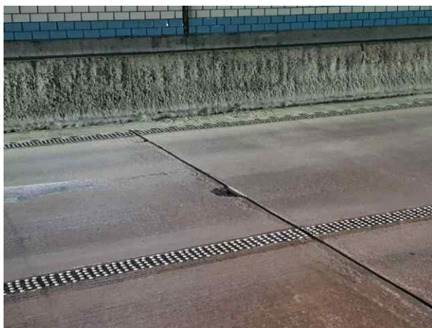
본선 포장부 S438 파손
