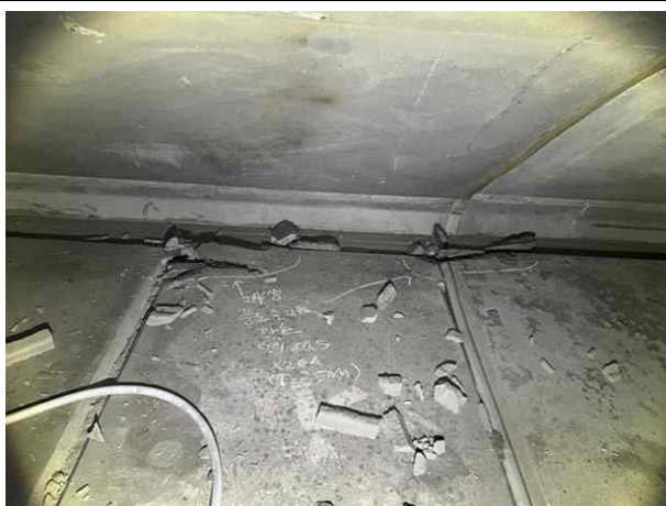
RAMP-D 풍도슬래브 S54 상면 파손
