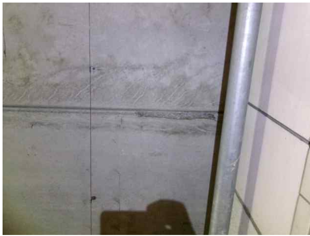
RAMP-D 풍도슬래브 S52 하면 파손
