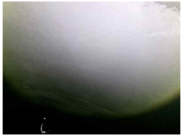
RAMP-D NATM구간 천단부 S51 균열(Cw=0.3mm)
