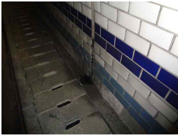
RAMP-D NATM구간 측벽부 S11 누수흔적
