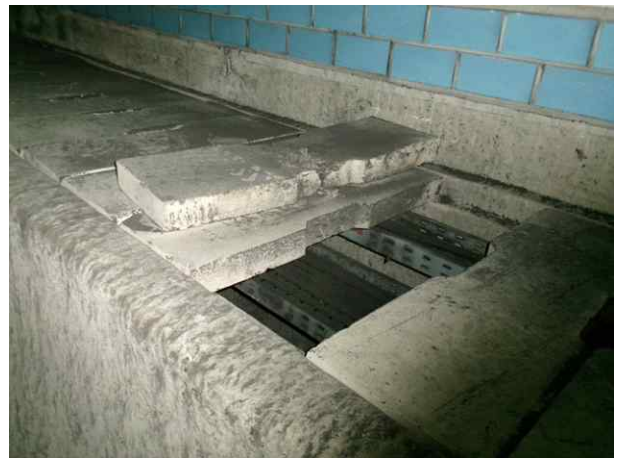
본선 공동구 S337 덮개파손
