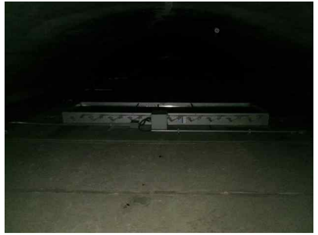
본선 NATM구간 풍도슬래브 댐퍼 전경
