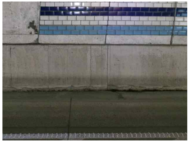
RAMP-D 공동구 S36 파손
