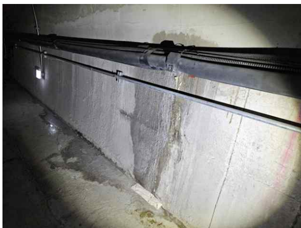
RAMP-D 전기실 측벽부 누수 및 백태
