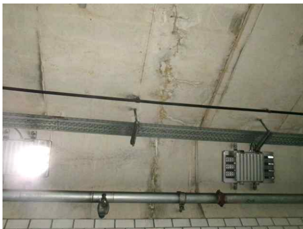
본선 BOX구간 슬래브 S714 균열부백태
