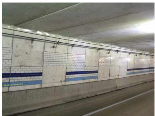
RAMP-D NATM구간 측벽부 S20~21 타일탈락
