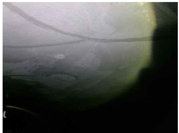
RAMP-D NATM구간 천단부 S14 재균열(Cw=0.5mm)
