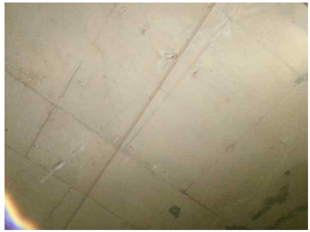
본선 BOX구간 슬래브 S003 균열(Cw=0.3mm)
