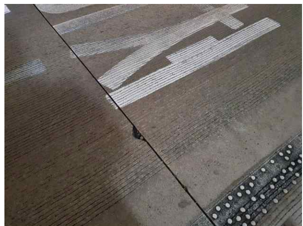
본선 포장부 S438 파손
