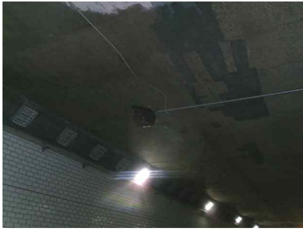
RAMP-D S59 신호기 파손
