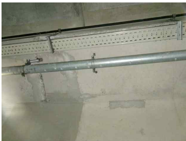
본선 NATM구간 측벽부 S035 균열(Cw=0.5mm)
