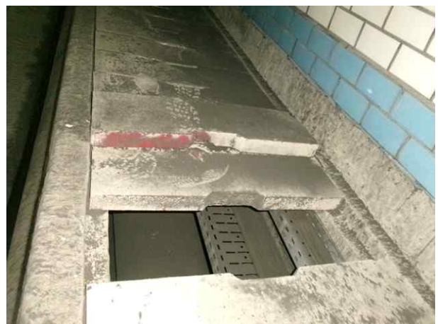
본선 공동구 S385 덮개파손
