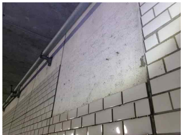
RAMP-D NATM구간 측벽부 S49 타일탈락
