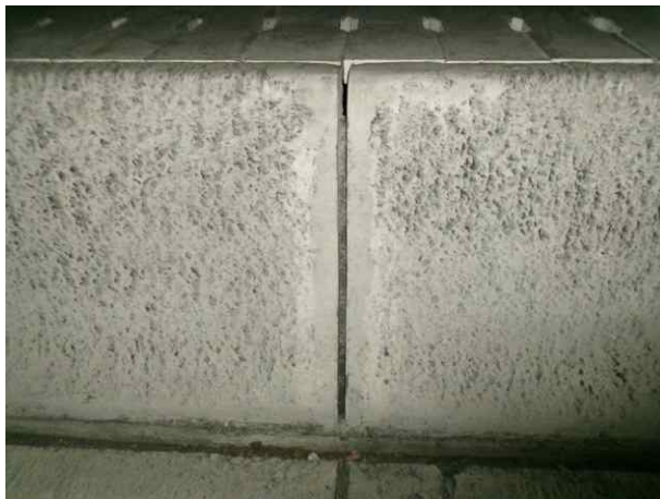
본선 공동구 S312 실란트 미시공
