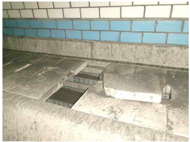
본선 공동구 S404 덮개파손
