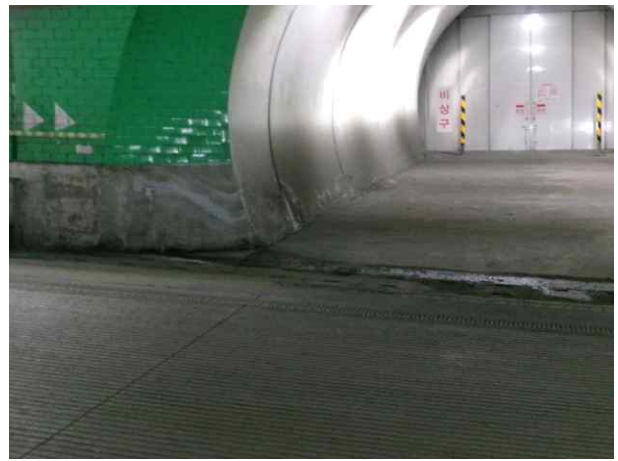
피난연락갱 S039 누수(떨어짐)
