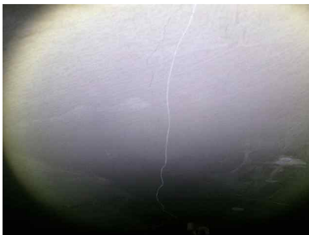
RAMP-D NATM구간 천단부 S20 균열(Cw=0.5mm)
