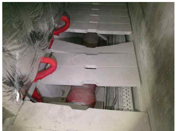
RAMP-D 공동구 S58 덮개파손
