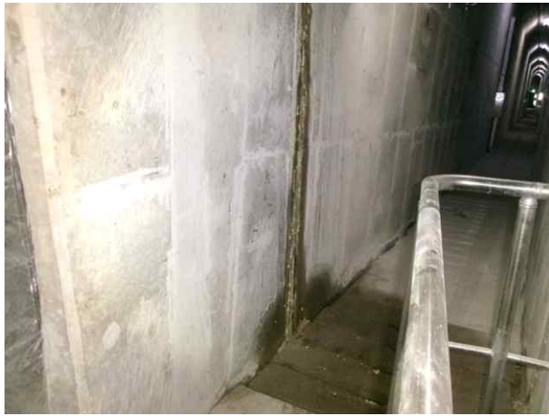
RAMP-D BOX구간 벽체 S57 누수(떨어짐)
