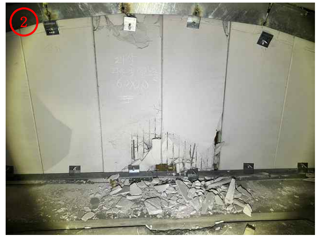
RAMP-D 풍도슬래브 S54 격벽 파손 및 철근노출(내측)
