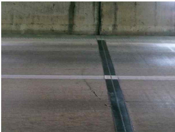
본선 포장부 S706 파손
