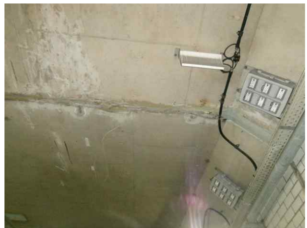
본선 BOX구간 슬래브 S003 누수(떨어짐)
