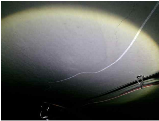
RAMP-D NATM구간 천단부 S03 균열(Cw=0.5mm)
