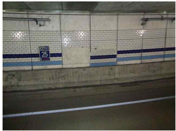
RAMP-D NATM구간 측벽부 S12 타일탈락
