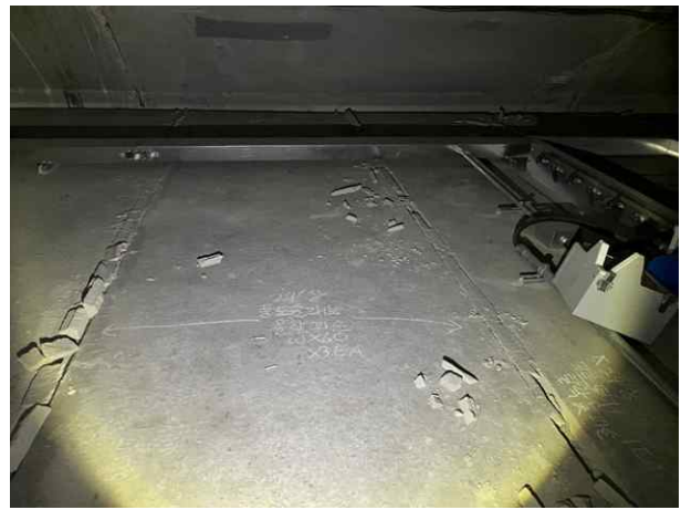
RAMP-D 풍도슬래브 S53 상면 몰탈파손
