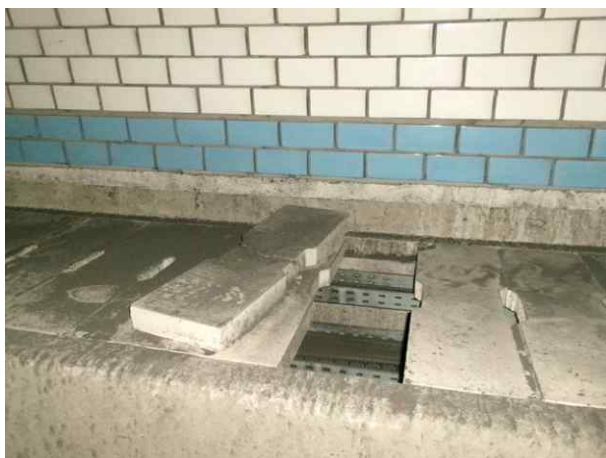
본선 공동구 S363 덮개파손
