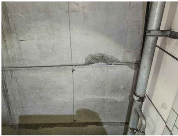
RAMP-D 풍도슬래브 S54 하면 파손
