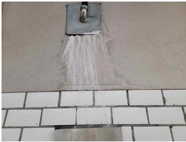
RAMP-D NATM구간 측벽부 S28 백태
