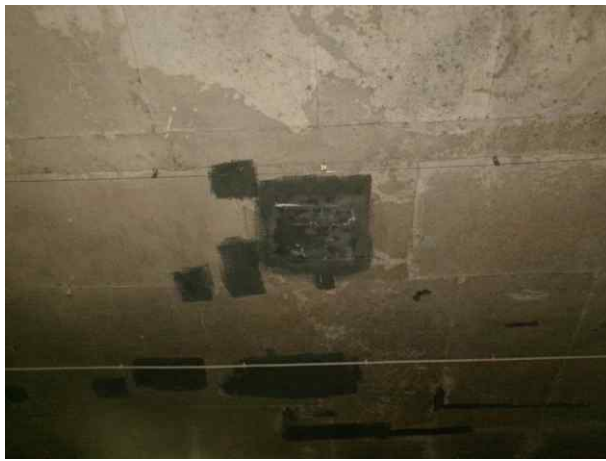
RAMP-D BOX구간 슬래브 S57 백태
