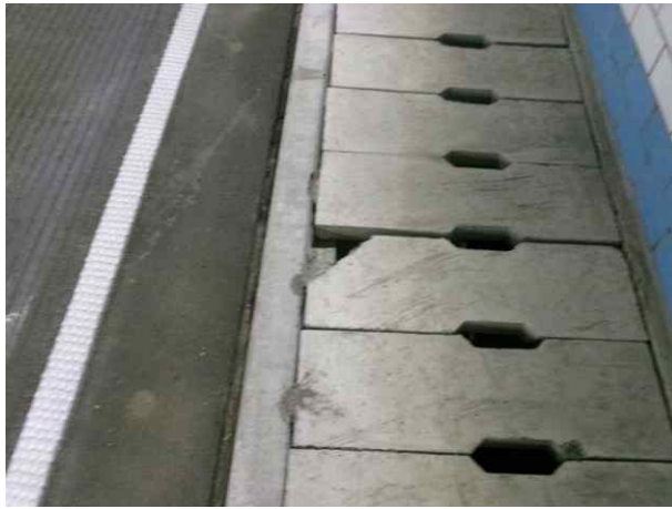
본선 공동구 S005 덮개파손
