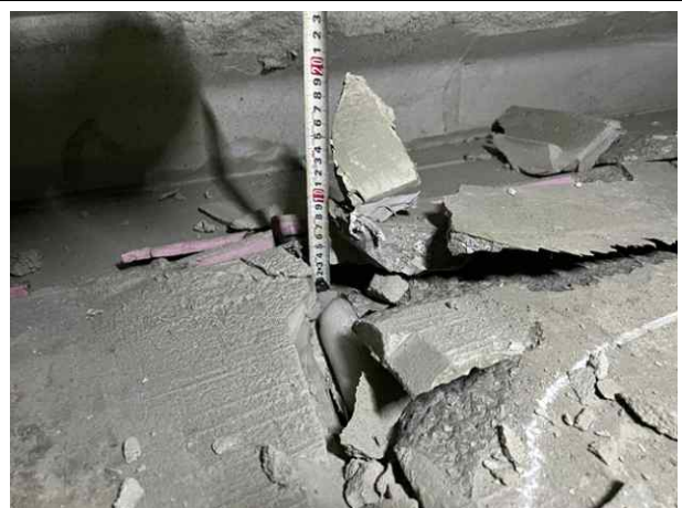
RAMP-D 풍도슬래브 S54 상면 파손
