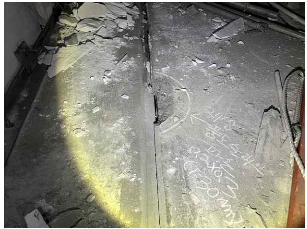
RAMP-D 풍도슬래브 S54 상면 파손
