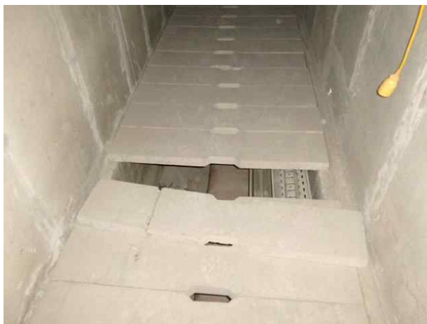
RAMP-D 공동구 S56 덮개파손
